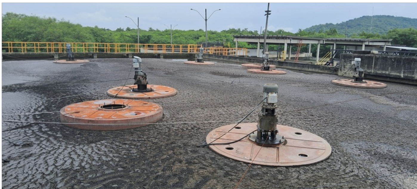
Foto 19 – Tanque de aeração
