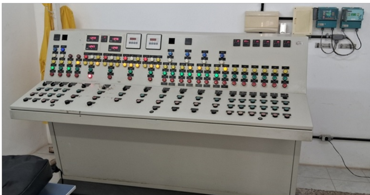
Foto 2 – Paineis de comando e medidores de vazão
