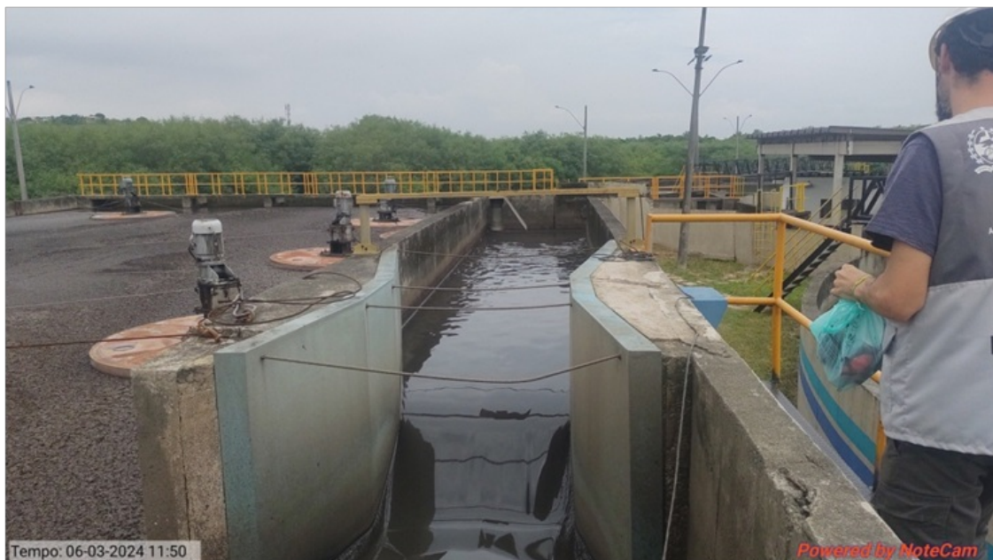
Foto 20 – Calha Parshall com medidor ultrassônico
