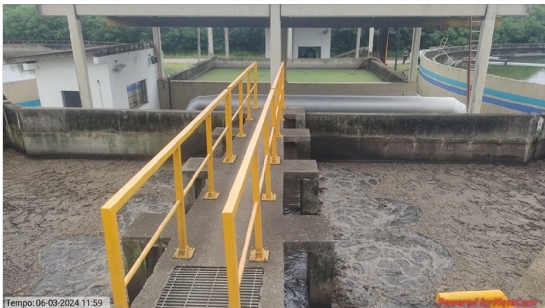
Foto 21 – Tanque e canal de recirculação
