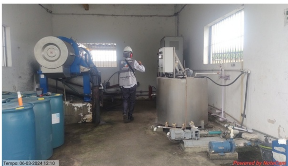
Foto 23 – Centrífuga, polímeros e demais equipamentos sistema recirculação
