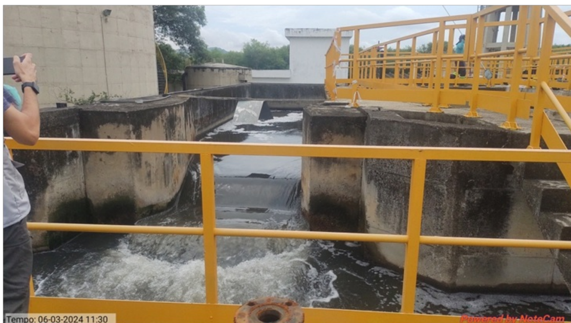
Foto 13 – Calha Parshall com medidor ultrassônico
