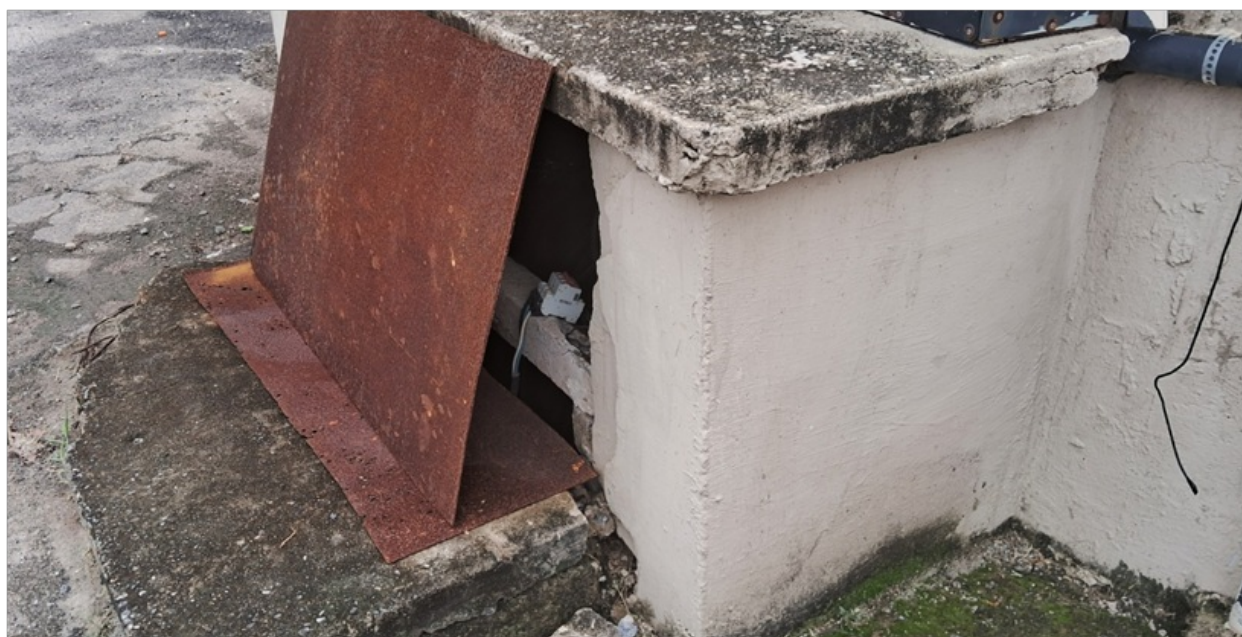
Foto 7 – Caixa lateral de visita elevatória
