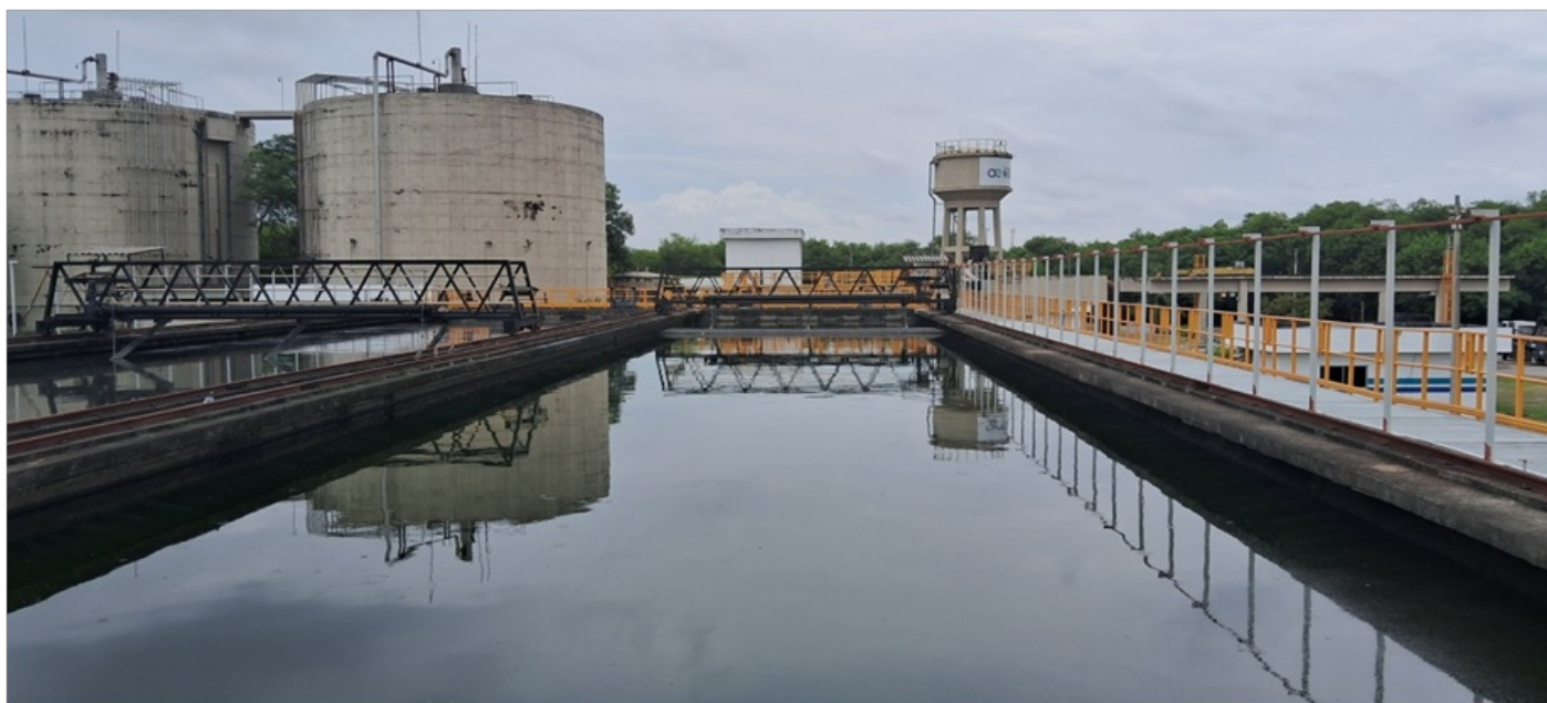
Foto 14 – Decantadores primários com raspadores de lodo
