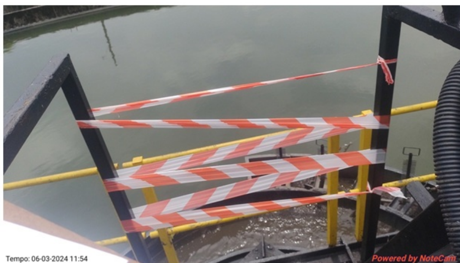
Foto 25 – Guarda corpo decanador secundário 2
