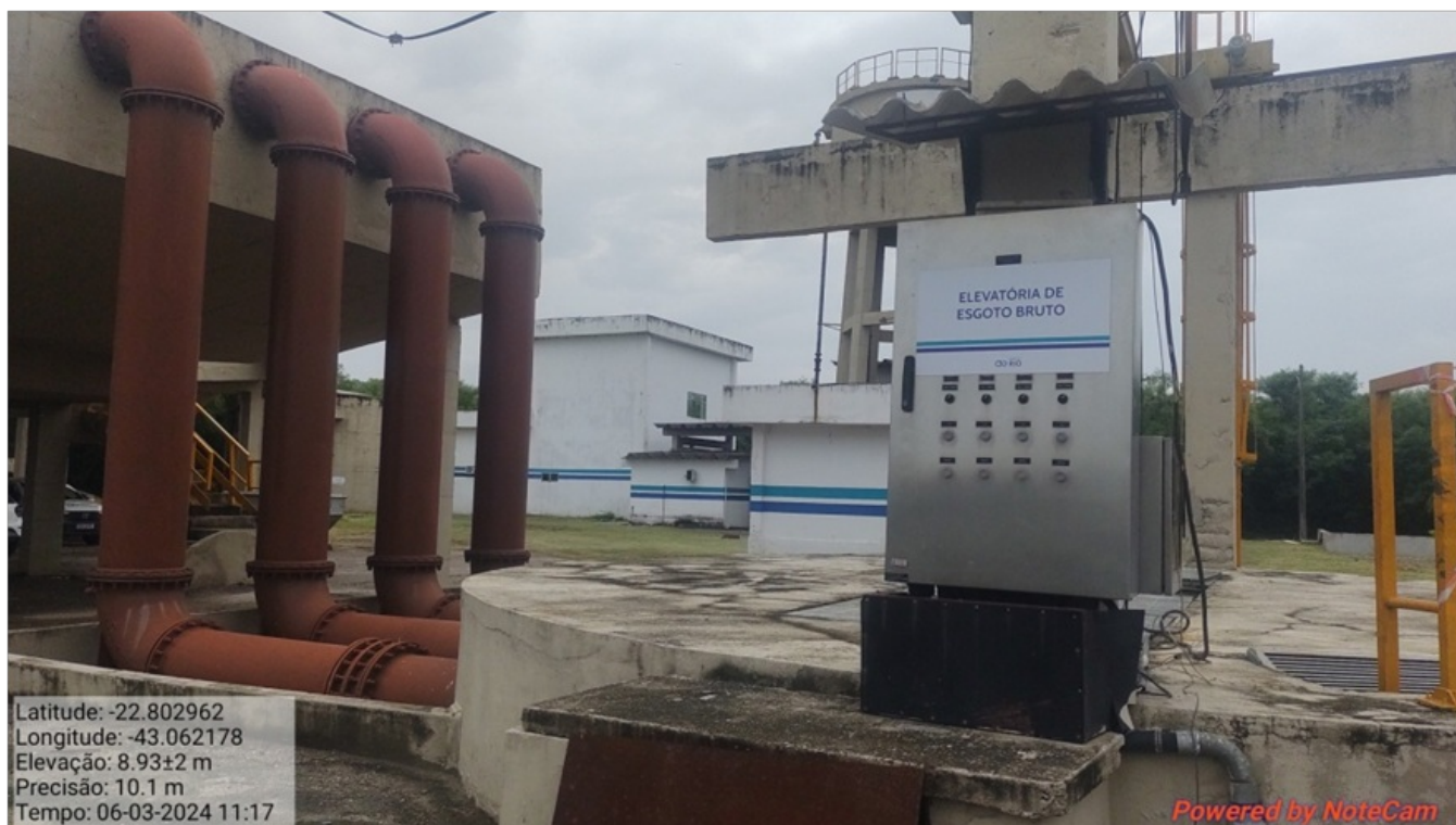
Foto 6 – Elevatória de esgoto bruto
